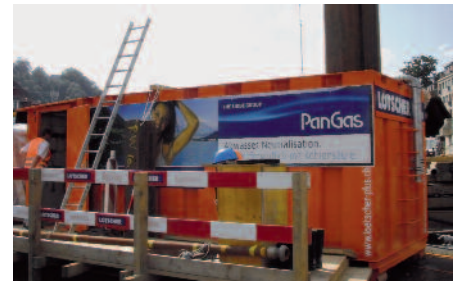
Automatische Neutralisationsanlage mit Kohlensäure
